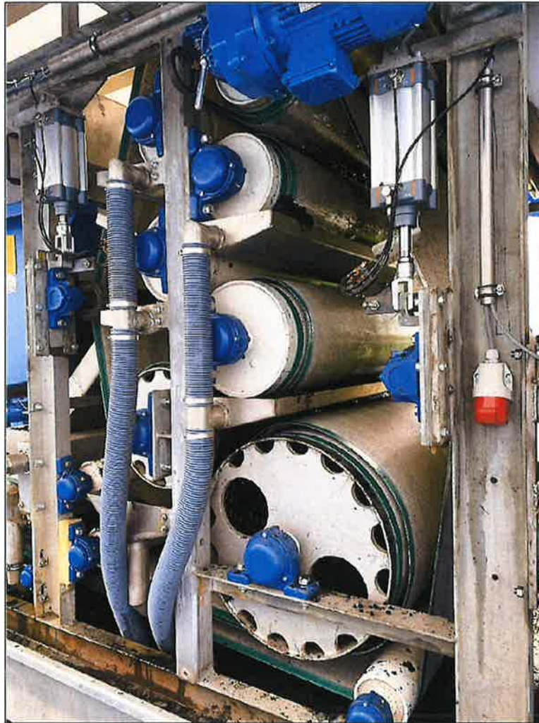
Figure 6 : Détail de la presse à déshydrater à bande.
