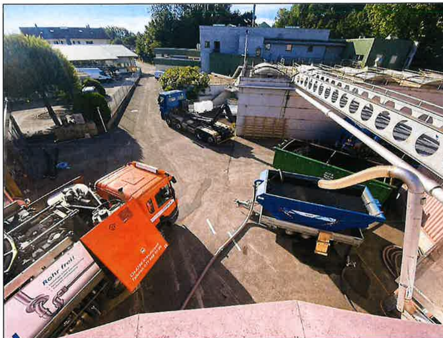
Figure 4 : Vue générale du dispositif – camion de pompage – benne d’homogénéisation – benne à boues déshydratées.
