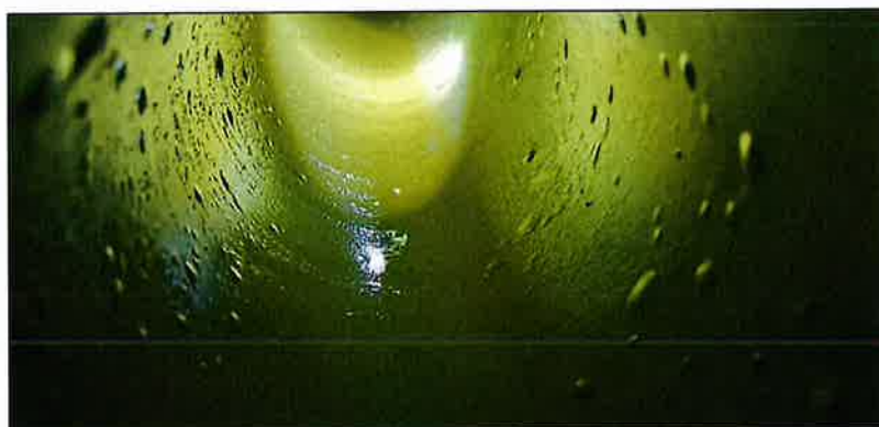
Etat du revêtement intérieur de la conduite : présence de bullage
